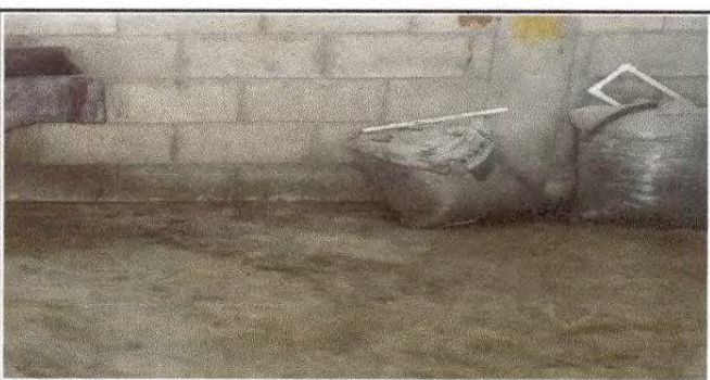
Foto 6: Sustrucción de Piso cerámico.
